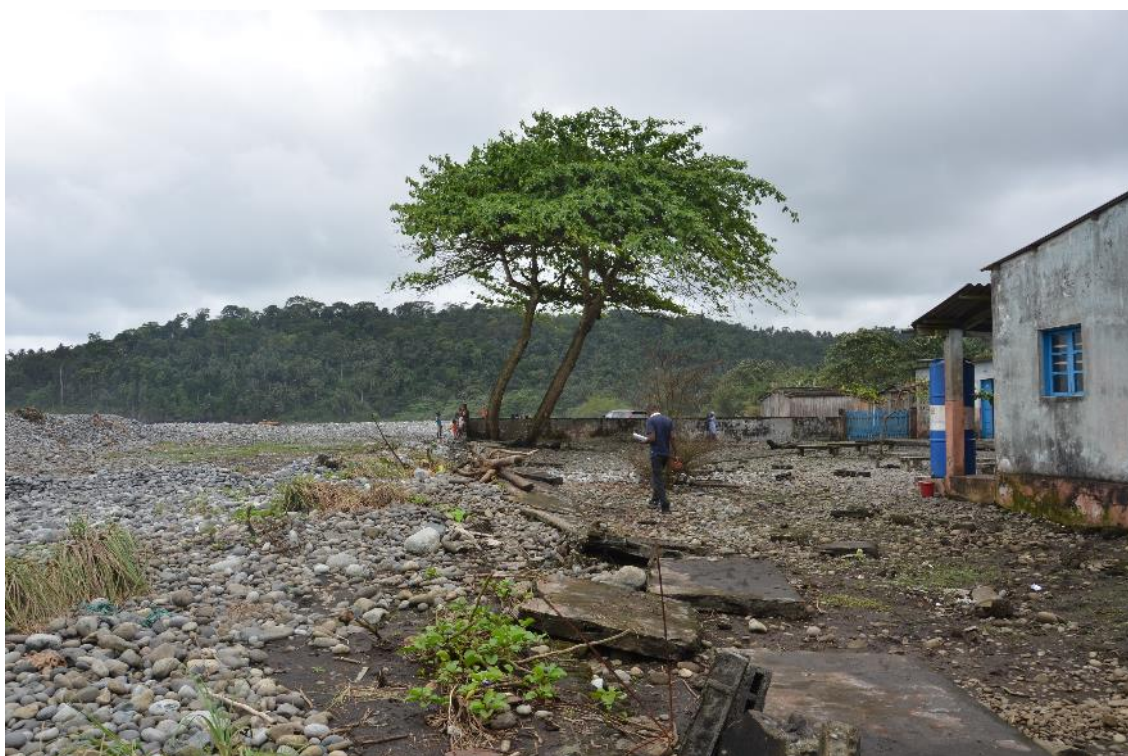
Iô Grande – muro de protecção da Escola recentemente destruído por vagas de mar
